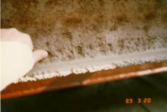
Abb. 1-19: Korrosion nach dem Sandstrahlen
