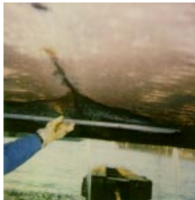
Abb. 1-12: Risse und Arbeitsfalten im Außenboden (2)
