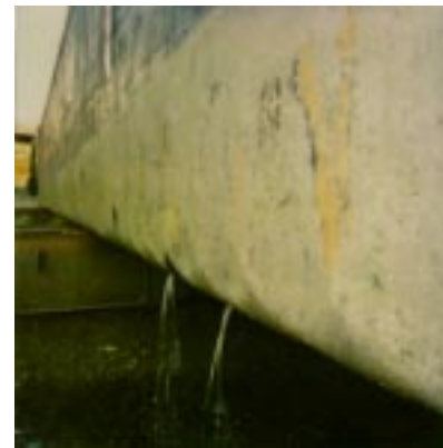
Abb. 1-13: Risse und Arbeitsfalten im Außenboden (3)
