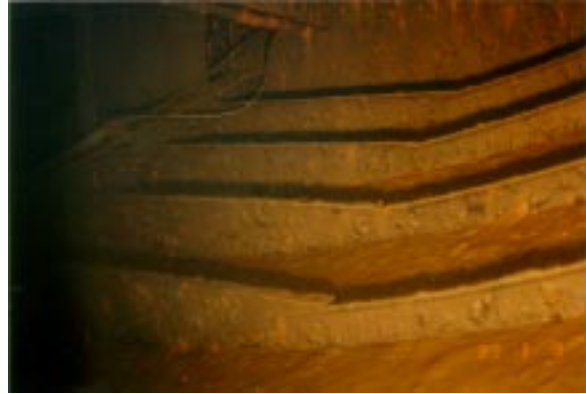
Abb. 1-20: Einfluß der Korrosion auf Verbände
