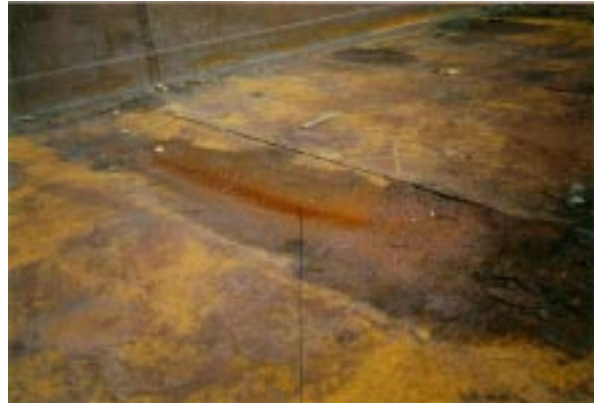
Abb. 1-6: Örtliche Verformungen im Innenboden Fig. 1-6: Local deformations in the inner bottom
